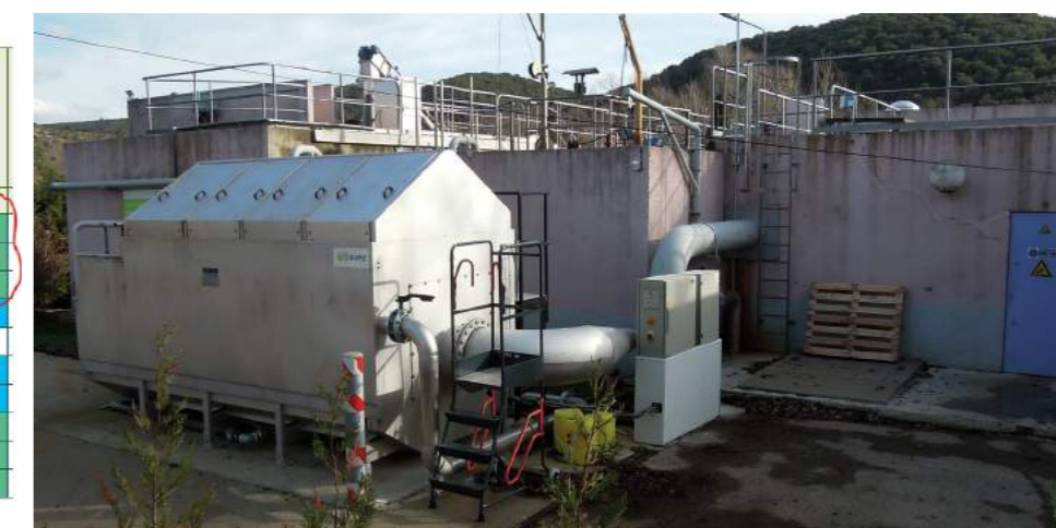
Filtre tertiaire de la STEP de Gréoux mis en place en 2016. Or pour fonctionner, ce filtre exige que le taux de matière en suspension (boue) soit très faible...
